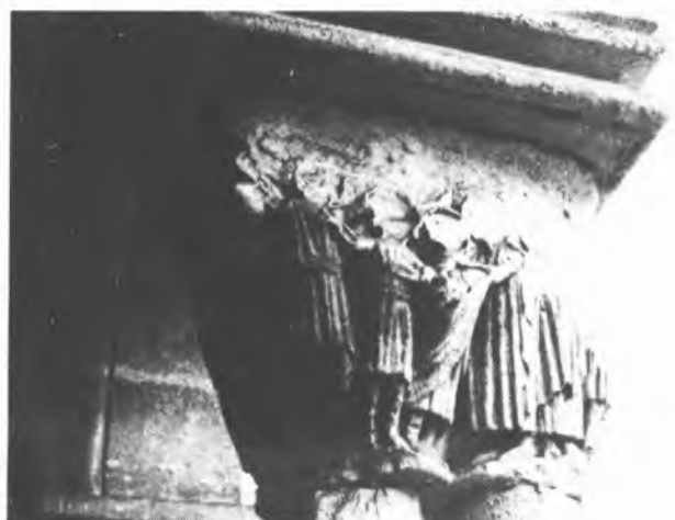
Fig. 4 Capitel em fase inicial de degradação em que são visíveis: pulverulência e perda parcial da forma
